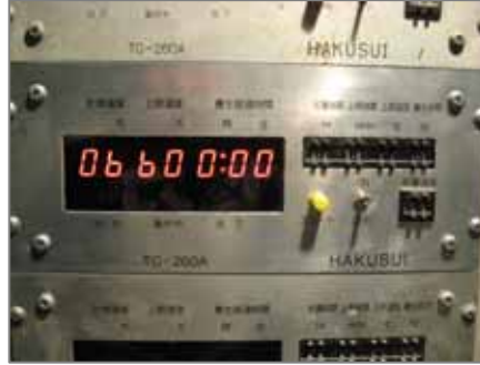
養生槽の温度制御装置 ハクスイ化成 TC-260A
